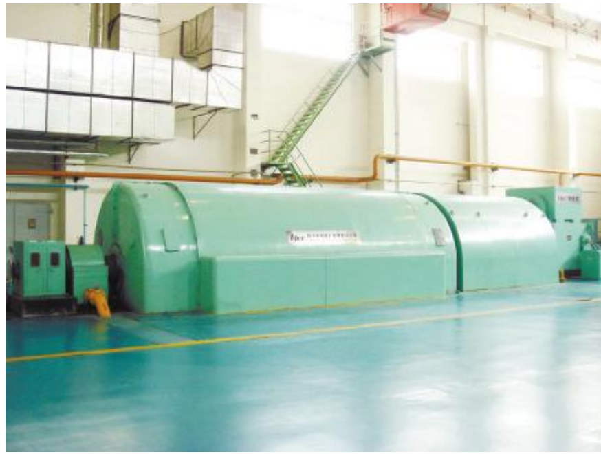
图为本次获奖项目的代表产品 6500MVA 短路试验发电机 供图 刘保生
