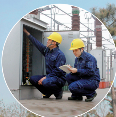
变电站雨后特巡
