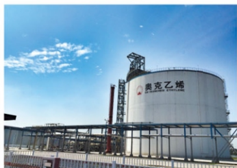
《奥克乙烯罐》 拍摄时间：2015年7月29日 作者：何丹丹 地点：扬州奥克 简介：蓝天白云下，号称中国第一罐的5万立方米低温乙烯储罐灵动起来。这是作者独具匠心的神来之拍。立足乙烯、环氧，创造价值从这里开始。
