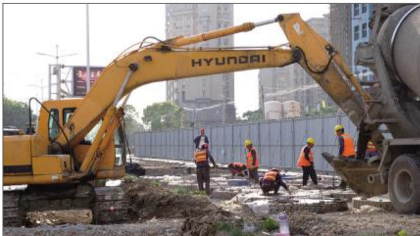
我区在大力发展经济的同时,通过加大城市基础设施建设力度等办法,不断改善市民的居住和交通环境,完善城市功能,努力将金坛建设成宜居宜业的现代城市。这是正在改造升级中的南一环。 穆述 摄
