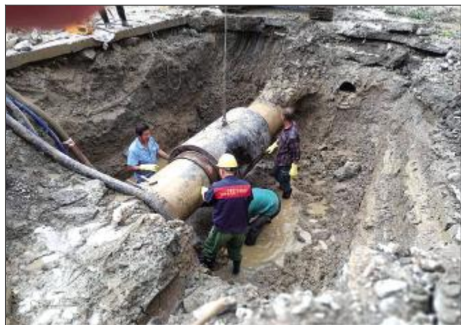
6月20日19:30,因城区东环一路如家酒店处DN600自应力管自然老化导致主管爆管,全区东环一路以西城区降压供水,其中金彩花园(含)两侧店面房、北园小区、金绣花园等暂停供水。接到市民投诉电话后,区自来水公司维修部工作人员及相关责任人共30人第一时间赶赴现场,组成应急抢修小组对爆裂水管进行连夜抢修,21日上午9:30,抢修工作顺利完成,维修部工作人员根据常州自来水公司统一调度,进行开阀送水。徐欢
