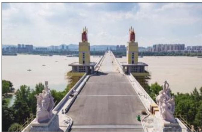
经过21个月封闭维修后的南京长江大桥,目前南桥头堡及雕塑等已拆除围挡,初露新颜,预计年底前南京长江大桥公路桥将完成维修改造,恢复通车。
