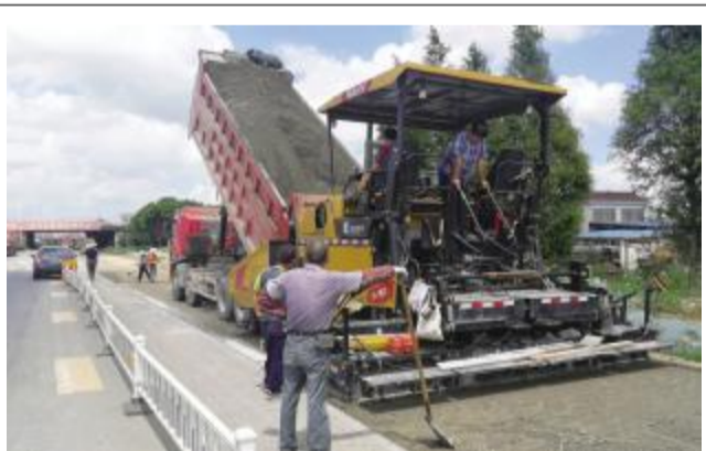
8月28日,金坛境内240省道改造提升工程——沿江高速至常溧高速段进行水稳摊铺。240省道金坛段改造提升工程全长10.775公里,包括沿江高速至常溧高速段改造7.293公里,北段盐港路到华城路3.482公里。其中高速段路基宽度从原来25.5米拓宽到33.5米,北段路基拓宽为56.5米,由原来双向四车道变为六车道,金坛境内240省道改造提升工程自去年12月底开始施工,高速段将于今年底完工。蒋建君 秦鑫伟 刘玲 文/摄
