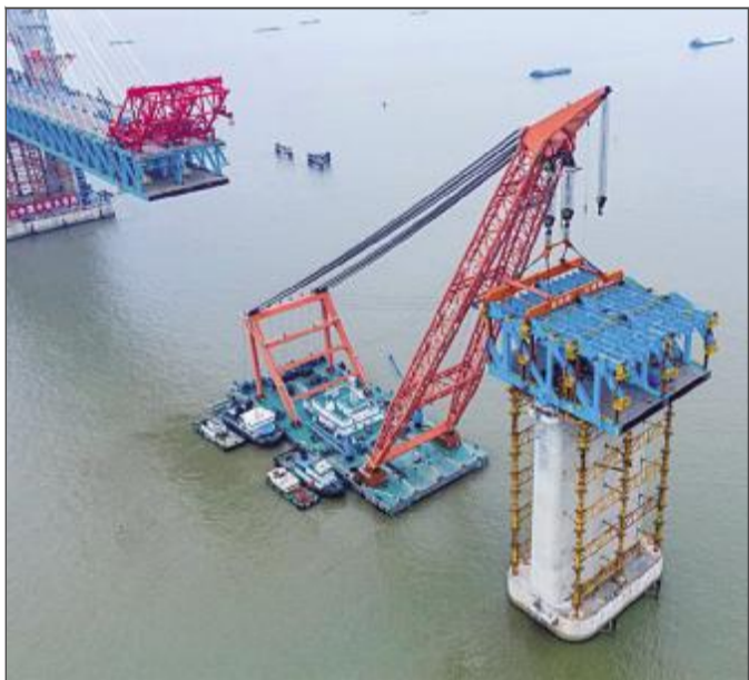
日前，沪通长江大桥27号辅助墩第3段节间钢梁吊装对接成功，标志着主航道桥墩顶钢梁架设施工全部完成。图为沪通长江大桥27号辅助墩第3段节间钢梁吊装施工现场（无人机拍摄）。 新华社
