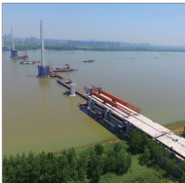
日前，南京长江五桥桥面施工正在进行，该桥采用的这种钢混组合梁，为世界首创的新型桥面板，桥面更抗压，使用寿命更长，预计2020年建成通车。 方东旭 摄
