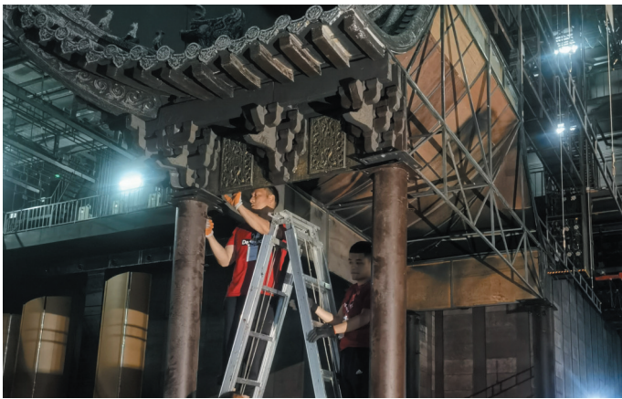
工作人员在常州大剧院舞台上搭建该剧重要布景“古戏台”。
