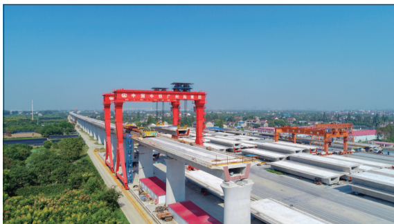
南沿江城际铁路起自南京南站,终于苏州太仓,途经金坛、武进等,全线设8个车站。目前金坛段进入箱梁架设阶段,预计2021年进入轨道施工阶段。 蒋建君/文 朱顺/摄
