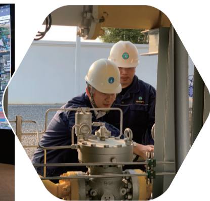
港华燃气公司工作人员对设备进行巡检
