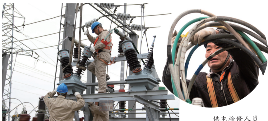
供电检修人员对35千伏西阳变电所电压互感器老化渗漏的设备隐患进行消缺。
