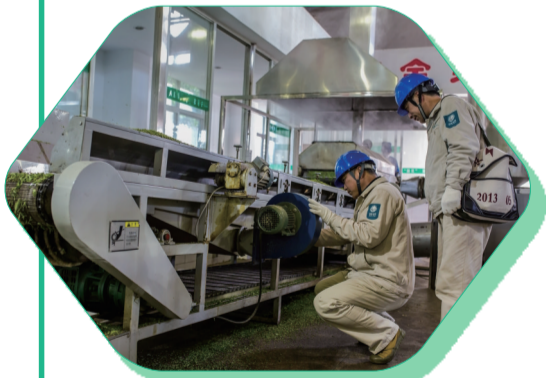
工作人员对汽热杀青机、冷却输送机等加工设备进行检查
