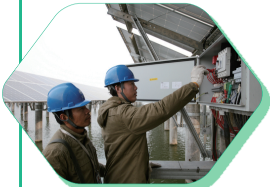
在亿晶光电“渔光一体”光伏电站检查检查汇流箱
