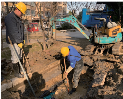
抢修人员积极抢修爆裂的自来水管
