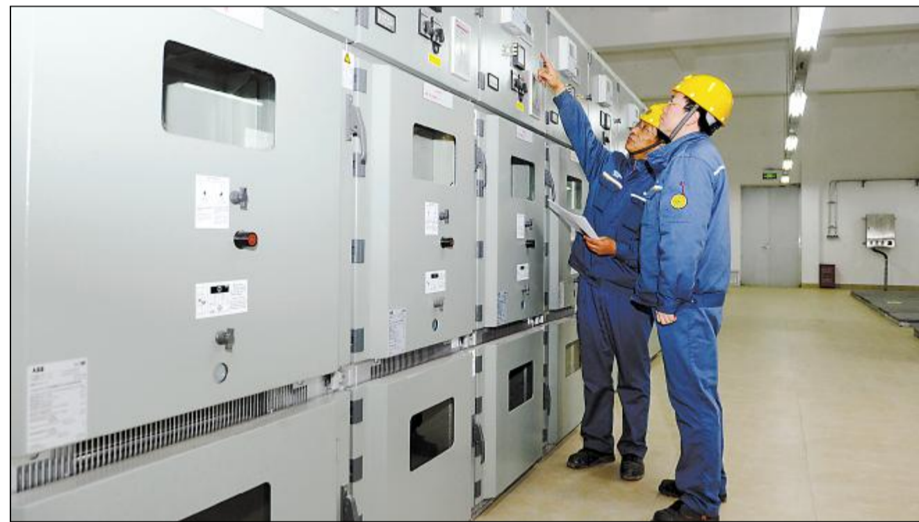
日前,宝钢股份能源环保部涂变电所110kV及低压系统一次受电成功,标志着涂涂区域供电设施改造工程第一步顺利完成,为公司重点项目“硅钢四期工程”顺利受电生产提供了可靠保障。图为员工在检查受电后的电气柜。
