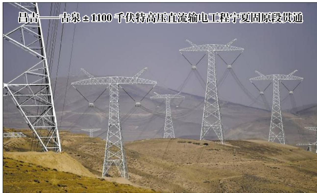
日前,昌吉—古泉±1100千伏特高压直流输电工程宁夏固原段线路正式贯通。宁夏固原段工程地处黄土高原沟壑区,线路全长85.4千米,新建塔159基。
