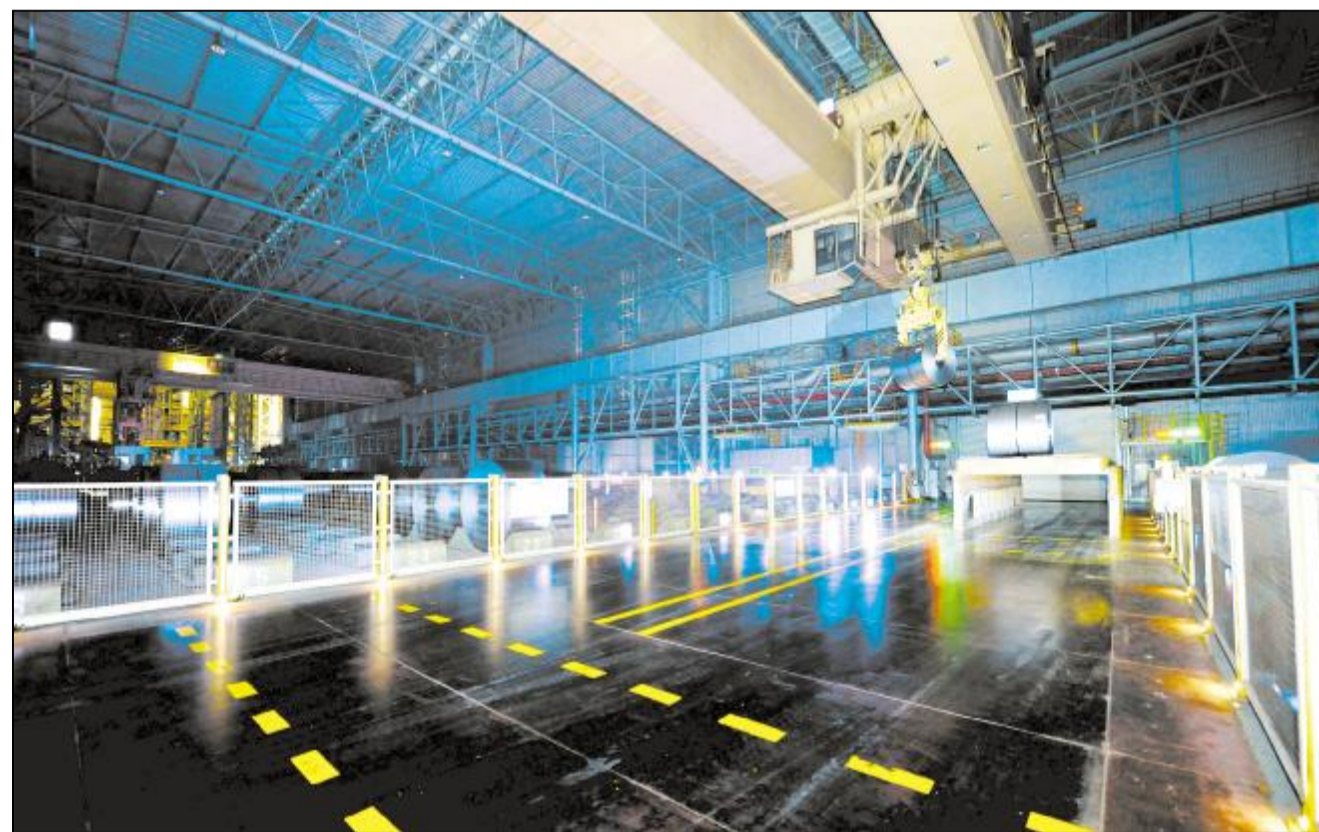
宝钢股份宝山基地冷轧厂持续推进自动化项目实施,其中C008前库及后库库区目前已完成行车无人化,行车作业自动率稳定在99%以上。图为无人化行车正在进行吊卷作业。
