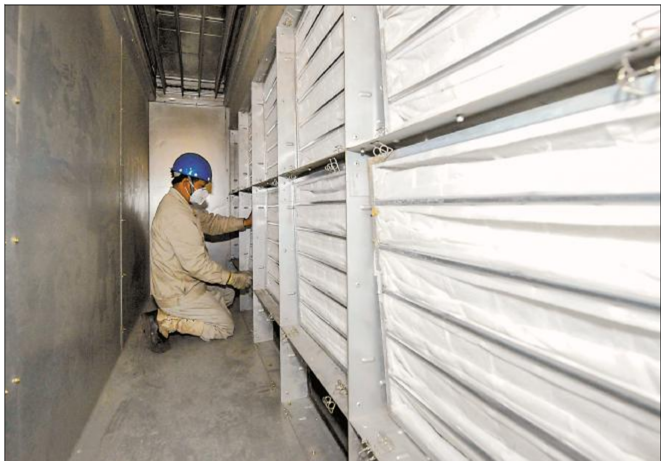
近日，为确保宝钢股份各生产单元空调设备设施正常稳定运行，宝钢发展源康物业有限公司空调维护部提前开展了高温前空调设备设施专项普查。此次普查近2万台套空调设备设施，重点对主生产线空调设备做检查。图为员工正为空调换上新的滤网。
