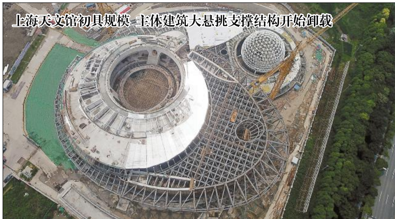
上海天文馆初具规模 主体建筑大悬挑支撑结构开始卸载。日前,上海天文馆(上海科技馆分馆)建设工程用钢量达2000多吨的大悬挑支撑结构整体卸载施工正式开始...
