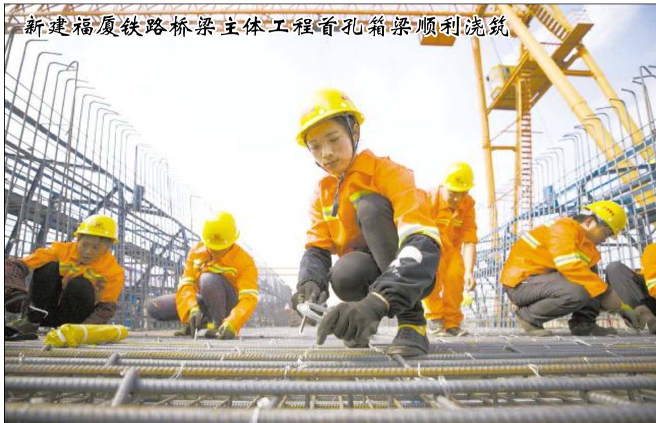
日前，福建首条高速铁路——新建福厦铁路桥梁主体工程首孔箱梁顺利浇筑，标志着桥梁主体工程由下部结构向上部结构有序推进。新建福厦铁路是国家“一带一路”建设重点工程，铁路正线全长277.42千米，预计2022年建成通车。
