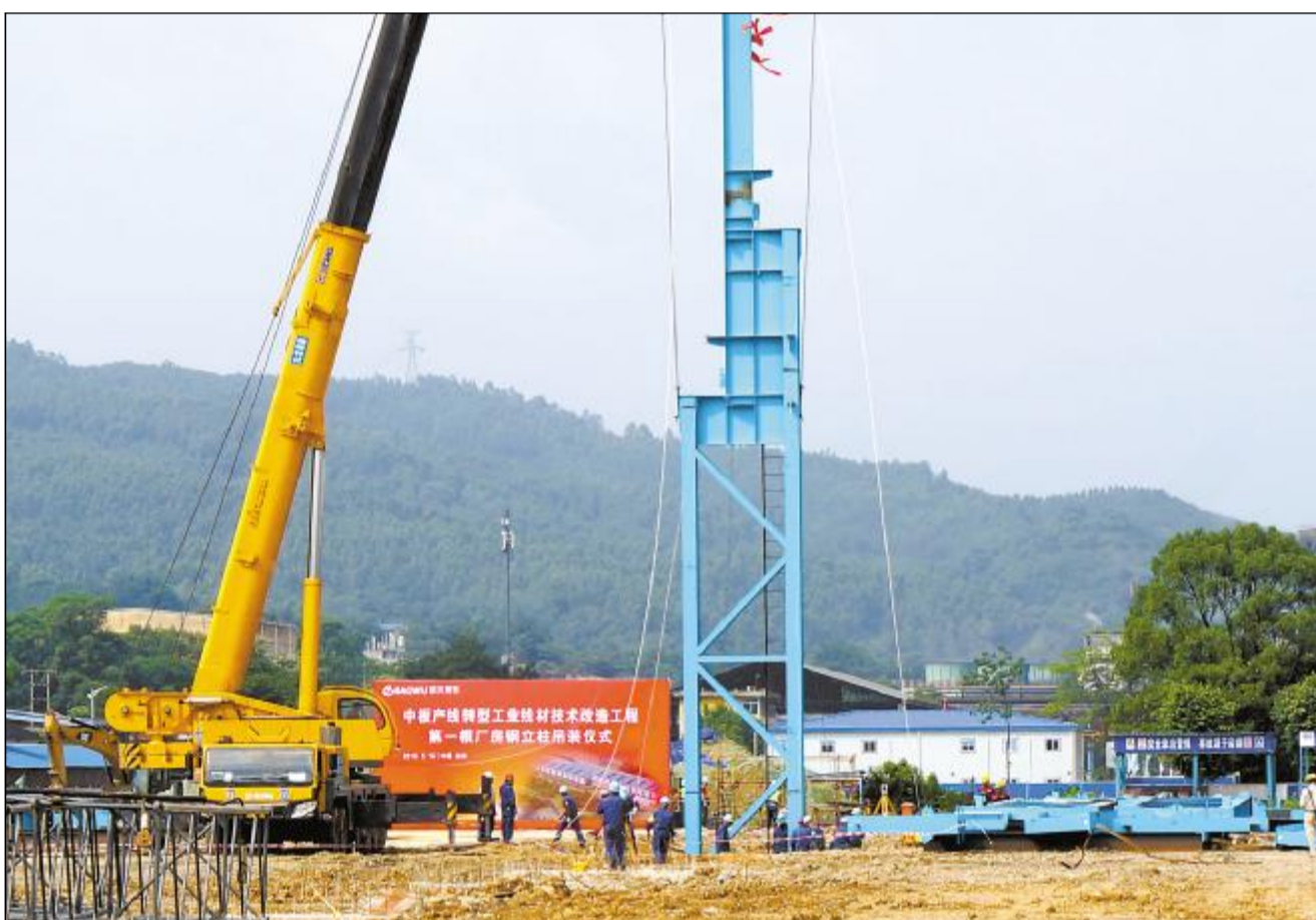
日前,韶钢高线三期第一根厂房钢立柱顺利完成吊装,项目正式进入安装施工阶段。韶钢高线三期项目按照世界先进、国内一流的目标规划设计,以建成先进的线材和大盘卷复合生产线,是韶钢打造优质棒线材生产基地的战略性工程。项目于去年5月启动。高线分支计划今年底热试,大盘卷分支计划明年年初热试。 特约通讯员 陈立新 通讯员 龚俊明 摄影报道
