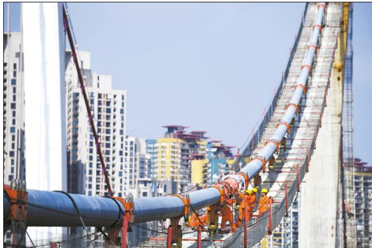
图为正加紧施工的横跨长江的重庆鹅公岩轨道专用桥。该桥连接重庆市九龙坡区和南岸区，是重庆轨道环线南环的控制性工程，全长1650.5米，其中主桥长1120米。
