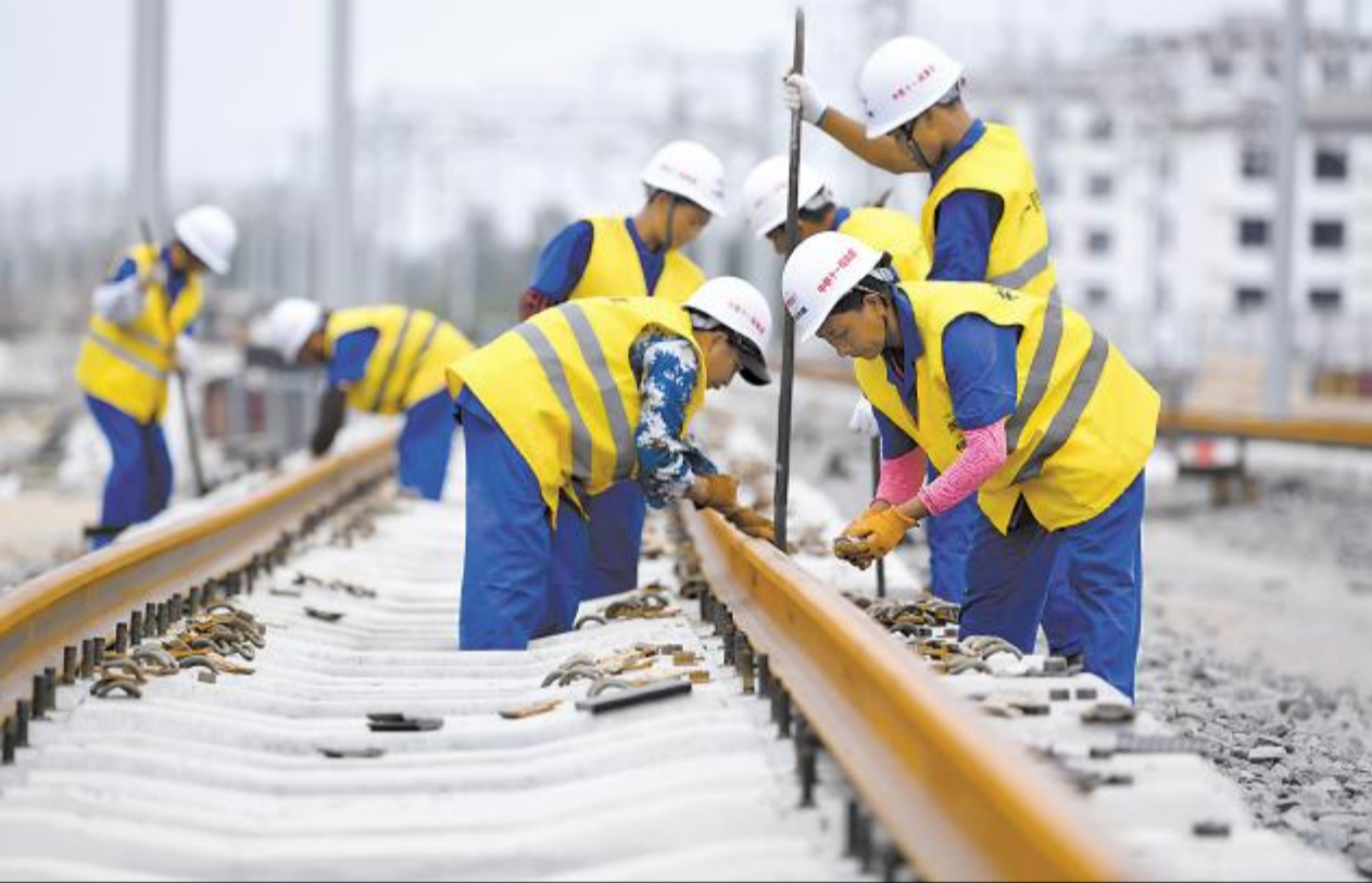
日前，商合杭铁路合肥北段最后一对500米长钢轨在安徽阜阳西站铺设完成，标志着商合杭铁路合肥北段铺轨贯通。作为我国“八纵八横”高速铁路网规划和京港高铁的重要组成部分，商合杭铁路开通后将实现河南、安徽、浙江三个省份交通动脉的“无缝对接”。
