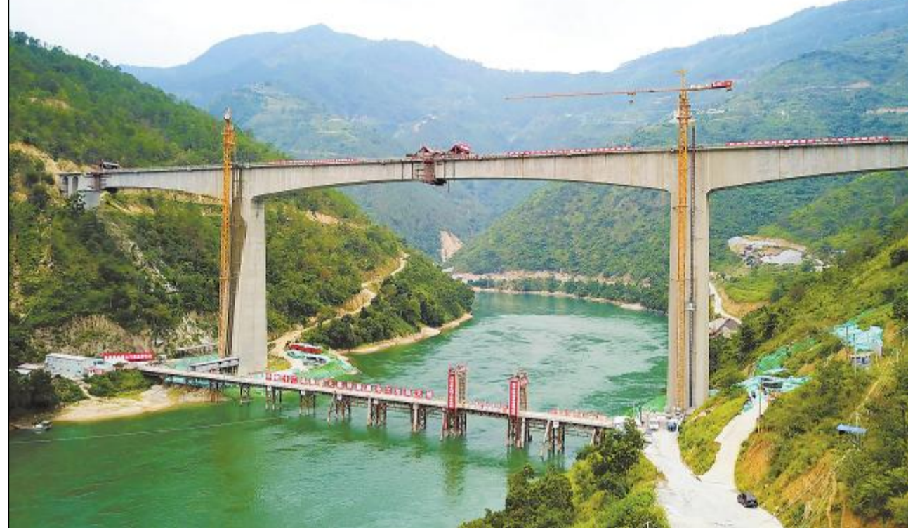
日前,由中铁十二局集团公司承建的中缅国际通道大(理)临(沧)铁路澜沧江双线大桥顺利合龙。该桥位于云南省大理州南涧县,是目前世界上在建的高地震烈度区最大跨度铁路双线连续钢结构桥,全长431.6米。
