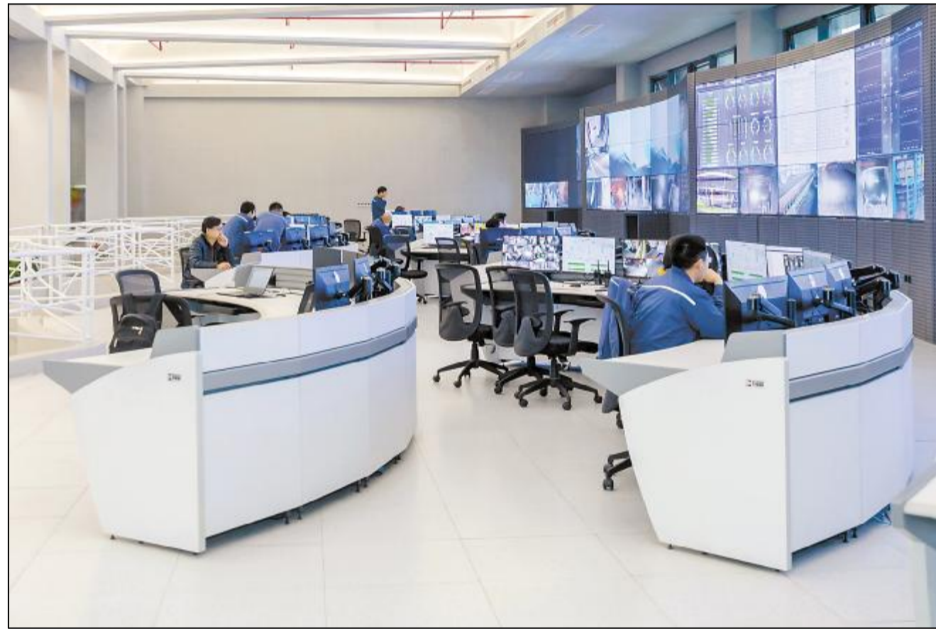
近日,鄂钢操作集控中心成功上线切换,率先在全行业实现钢铁工序全流程远程集控,是践行中国宝武“产业智慧化、智慧产业化”理念的具体实践。在去年经营管控系统成功上线的基础上,今年,鄂钢与宝信软件携手,再次创造了“鄂钢速度”,相继开发了鄂钢经营决策支持系统、厂可视化系统、现场智能装备及远程操作集控系统,初步形成了以运营管理中心、操作集控中心及现场智能装备于一体的智慧制造空间格局。图为鄂钢操作集控中心。
