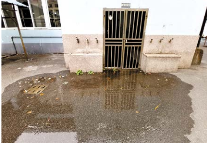
月浦单宿舍废弃茶水间漏水。
