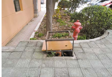
一钢宿舍区域，井盖临时架设影响通行。
