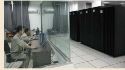
八钢整体产销管理系统机房，摄于2008年
