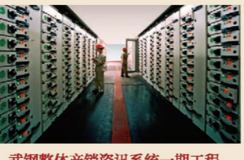
武钢整体产销资讯系统一期工程，摄于2004年
