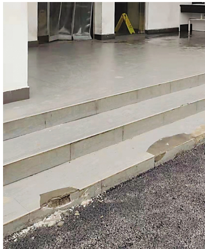
宝武股份钢锭模食堂，门前台阶失修，有的修补不到位，“坑”坑不休。
