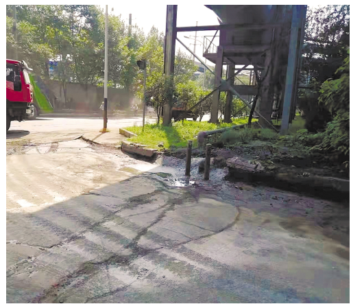
武钢有限三炼钢西路上，炼铁厂六号高炉铁路桥附近，晴天路面常有积水。
