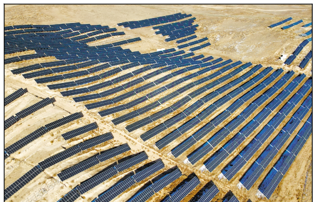
国家能源集团宁夏电力公司 20 万千瓦光伏项目是我国内开工建设的首批大型风电光伏基地项目之一,明年年底实现全部容量投产。该项目建成后,每年可为浙江华东地区输送三十七亿度绿色电能,减少二氧化碳排放三百一十万吨。图为国家能源集团宁夏电力公司 20 万千瓦光伏项目。新华社供图
