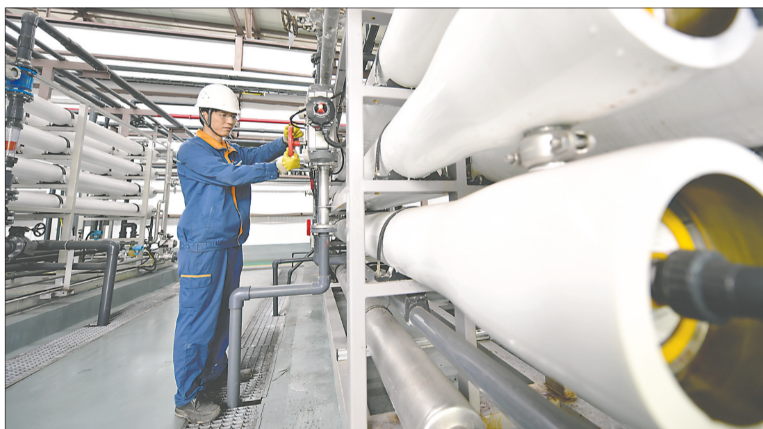
宝钢股份宝山基地能源环保部狠抓吨钢耗水指标，通过优化生产工艺和管网查漏等措施，1月吨钢耗新水环比下降1.7%，创历史新低。图为水处理站员工正在操作RO反渗透装置。
