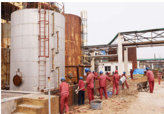
为确保在时间节点前完成公司安全整改项目，近日，建安公司防腐车间举全车间之力全面投入到环氧丙烷罐区围堰的重新修筑工作中，为确保环氧丙烷装置安全生产、稳定运行提供保障。
