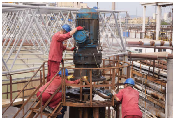
7月3日，聚醚厂压滤车间在分厂保运组和建安公司机运队吊车配合下，对VE2752和VE2753上清液溢流罐存在故障的搅拌机减速机进行维修。搅拌机正常运转后，保证了上清液始终处于悬浮状态，有效避免了固体颗粒沉积罐底，堵塞管路，影响压滤效果，确保了环氧丙烷质量的稳定。图为搅拌机检修现场。杨宇文/摄
