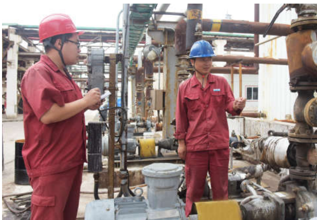
聚醚厂切实推进精细化管理，强化工作职能，严格设备管理，工程技术人员深入生产现场，发现问题及时处理，为下半年安全稳定生产奠定设备基础。图为工程技术人员和岗位人员在环氧丙烷装置现场检查设备运行情况。
