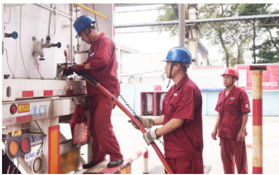
公司各单位乘上半年强劲生产态势,进一步夯实安全生产管理,加强现场检查督导,严格执行“八证”制度,为下半年生产提供安全保障。图为安全管理人员在氢气充装系统现场指导操作。杨宇文/摄
