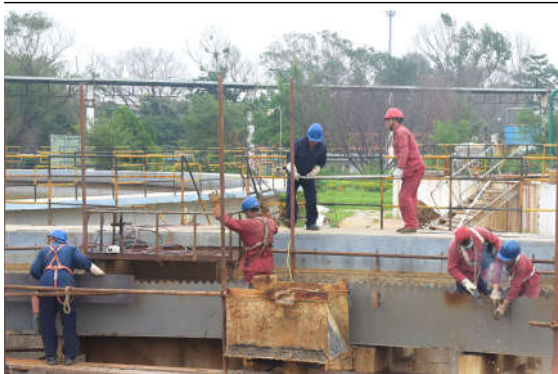
公司持续加大环保整治力度,7月18日,在相关单位的密切配合下,472二沉池溢水槽提标改造工作圆满完成,对提高污水出水水质、降低悬浮物,持续保证 COD 达标排放,起到了积极作用。图为提标改造现场。杨宇文/摄
