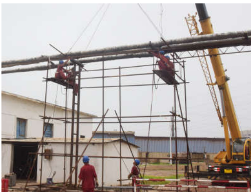
近日，建安公司机运队圆满完成氯碱厂盐水车间办公楼前架空蒸汽管路支撑移位工作，此项任务的完成，消除了蒸汽管路支撑不稳固的安全隐患，为三季度生产保驾护航。图为施工现场。杨宇文/摄
