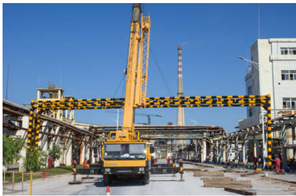
8 月 15 日,按照公司安全整改要求,由建安公司承做的大型限高杆在中央路西侧首端安装完成,有效防止大型机车非正常行驶时,对管路桁架造成损害,杜绝安全事故发生。图为限高杆安装现场。杨宇文/摄
