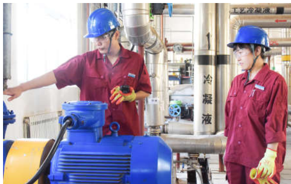
氯碱厂十二万吨离子膜车间岗位员工认真做好装置设备巡检工作，对巡检中发现的问题及时处理，将安全隐患消灭在萌芽中，确保装置安全稳定经济运行。图为岗位员工正在蒸发工序认真巡检。 杨宇文 / 摄
