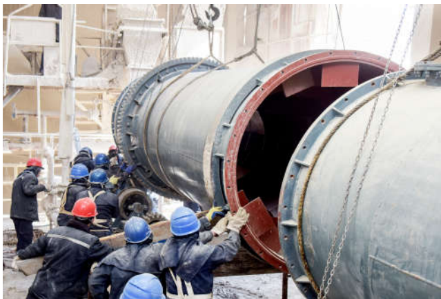
经过前期周密的安排和准备，3月6日，在维建公司氯碱检修车间的大力配合以及生产厂家的技术支持下，聚醚厂更换的A台化灰机主机吊装到位，按计划进入辅机安装及装置调试阶段。新化灰机投用后，既可消除设备安全隐患，又可使石灰制乳的质量得到进一步提高，为公司顺利实现首季开门红保驾护航。图为化灰机吊装现场。 杨宇文/摄
