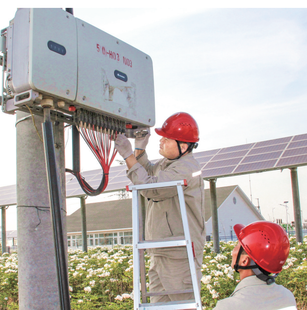
位于永城市的永城鑫能刘河80兆瓦农光互补项目自2018年6月14日并网发电,年均可实现上网电量1亿度,每年可节约标准煤约3.2万吨,减少二氧化碳、氮氧化物排放量约8.6万吨、1500吨。图为近日,该项目的工作人员正在开展日常检查工作。
