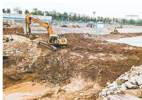
为提高汤河、姜河、淤泥河防洪能力,汤阴县韩庄镇投资1.43亿元对24处水毁灾后重建工程进行治理修复。图为4月15日,韩庄镇对汤河段部路桥水毁工程进行恢复重建施工。本报记者秦名芳 通讯员张白瑞 摄
