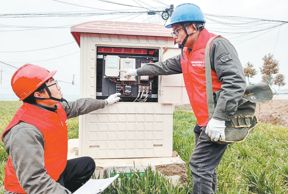
2月19日,国网平舆县供电公司共产党员服务队到杨埠镇王店村巡视机井灌溉设备,强化各项保电措施,确保群众春耕用电无忧。 本报记者黄华 通讯员闫梦珂 申政法 摄
