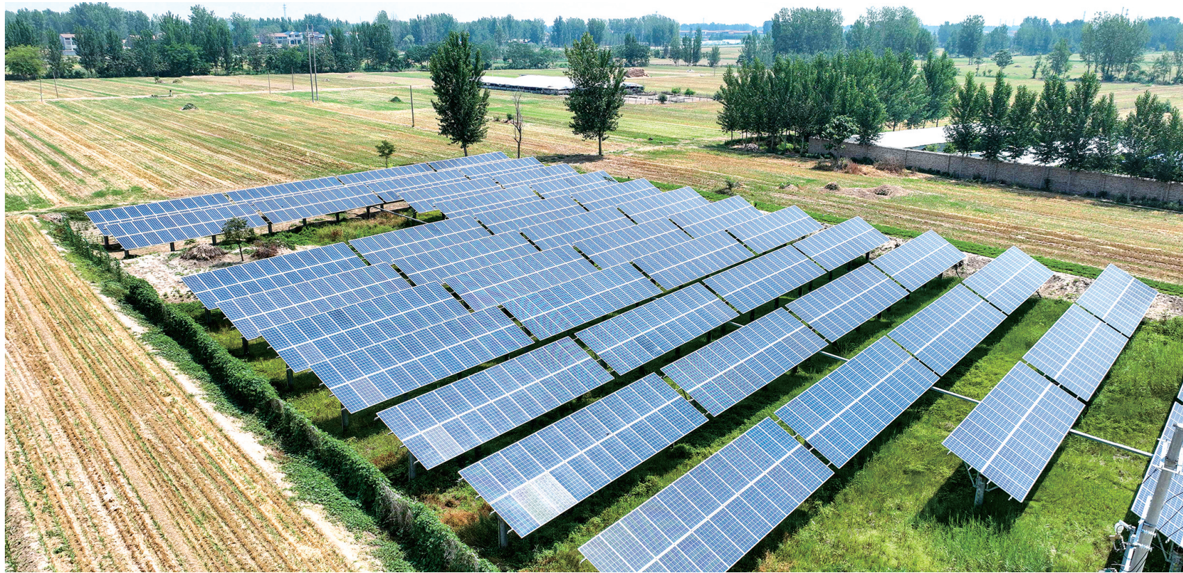
6月20日,宁陵县乔楼乡八里曹村,1000余块光伏发电板整齐排列在村东侧,在阳光照耀下熠熠生辉。目前,该县共有106个光伏电站,全年可完成发电量3700万度,收益将用于支持全县巩固脱贫攻坚成果。 本报记者 杨远高 通讯员 华梓渝 摄
