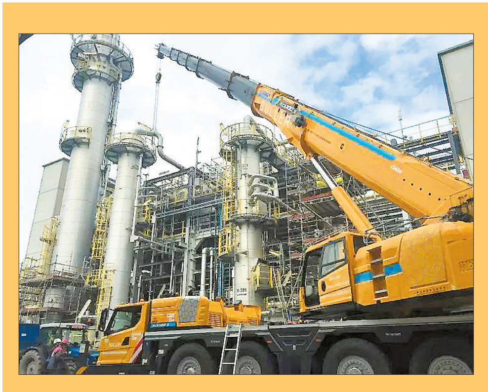
日前,徐工全地面起重机“登陆”德国,实现高端市场新突破。据介绍,这台针对欧盟高端市场倾心打造的全新G一代产品——XCA100_E全地面起重机,是我国在重型机动车产品欧盟整车型式领域首次获批认证。图为该起重机在德国最大化工园区Chempark Marl施工现场。
