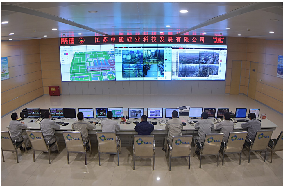
江苏中能硅业科技发展有限公司新建成的全国最先进的集生产工艺控制、视频监控、人员定位和应急救援为一体的安全生产指挥调度中心投入运行。
