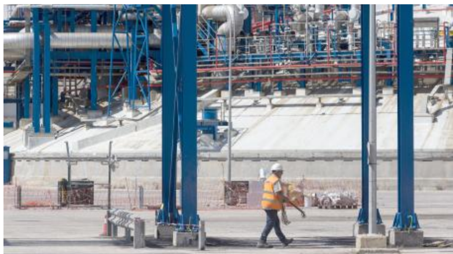
9月21日,一名工作人员在希腊雷苏萨液化天然气接收站工作。雷苏萨液化天然气接收站是目前希腊境内唯一一座液化天然气接收设施。新华社发(马里奥斯·罗洛斯 摄)
