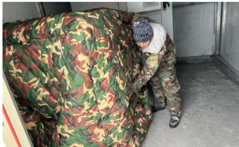
近日,克一河森工公司信息中心为9个基站蓄电池组加装防寒设施,延长基站蓄电池充放电时间,保证深山无人区信号“满格”,保障通信网络正常运行。 ■王大萍 摄
