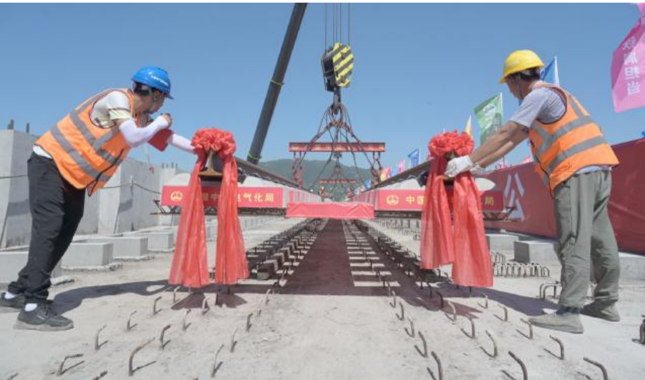
6月1日,中国中铁电气化局施工人员在福州滨海快线首占西高架铺设轨排。 当日,福州滨海快线开始铺轨施工建设。滨海快线是连接福州主城区与长乐滨海新城以及福州长乐国际机场的快速轨道交通线,全长约62.4公里,设计时速为140公里。 新华社记者 林善传 摄
