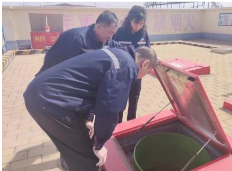
近日，阿里河森工公司物资供应中心加油站开展安全隐患排查工作，重点检查加油站油罐区、加油区、卸油口等部位安全设施及设备运行情况，对排查出的隐患制定整改措施，严防各类安全事故发生。图为技术人员正在检查输油管道。 ■胡静摄
